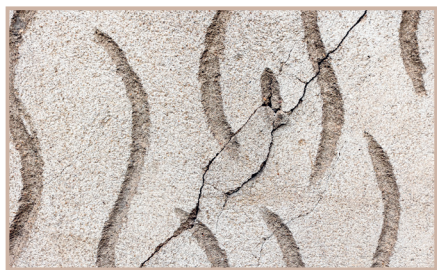
↑ Obr. 32: Týn nad Vltavou, Základní škola Týn nad Vltavou, Malá Strana (dříve Základní devítiletá škola), detail porušení rýhované omítky vlivem různé tepl. roztažnosti jednotlivých vrstev omítky. Foto: David Peltán, 2024
