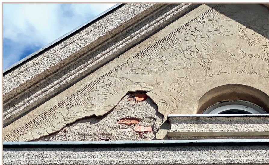
↑ Obr. 49: Bechyně, Křížíkova vilová čtvrť, detail poškození omítky štítového průčelí. Foto: David Javorský, 2023
