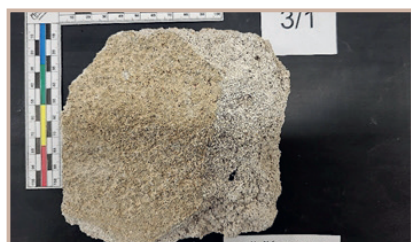
↑ Obr. P04: Pohled na omítku. Lícová strana.
