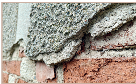
↑ Obr. 33: Týn nad Vltavou, Bohunická ulice, objekt při čp. 40, detail poškození omítky - infiltrace vody a působení mrazu způsobují odpadávání stále větších ploch omítky. Foto: David Javorský, 2024
