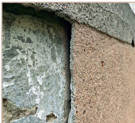
↑ Obr. 30: Chvalešovice, dům čp. 19, detail porušení omítky vlivem příliš hladkého podkladu, nedostatečná přilnavost. Foto: David Javorský, 2024
