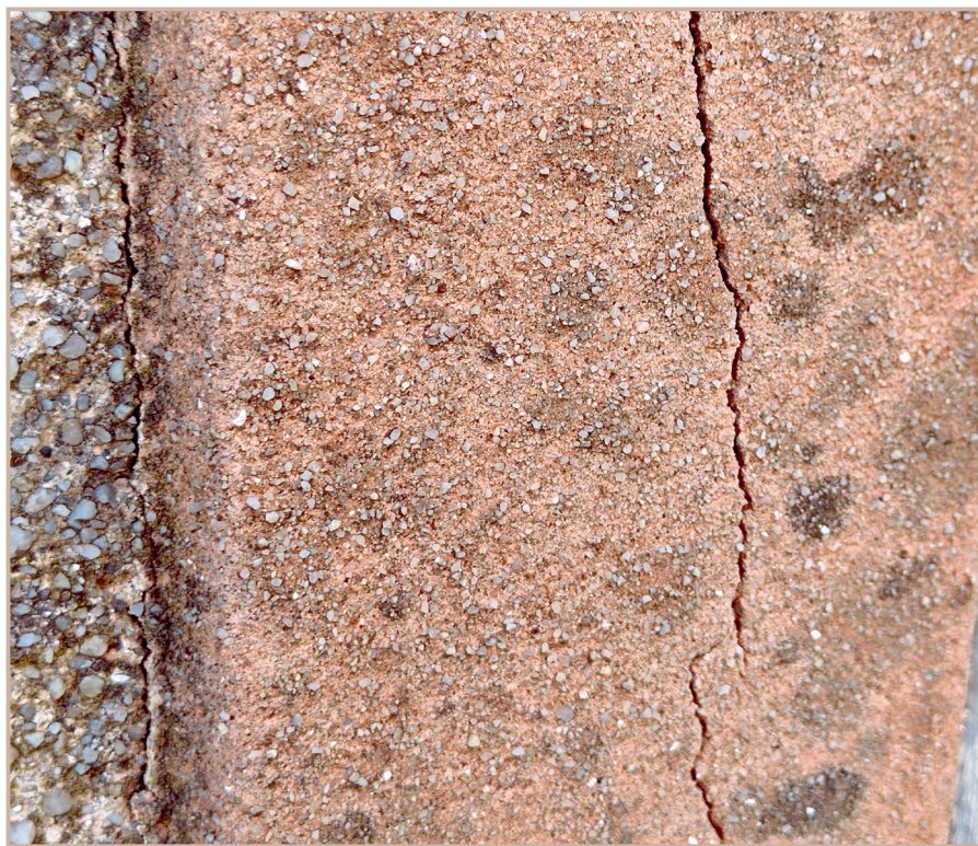
↑ Obr. 34: Neplachov, bývalý hostinec Josefa Šafáře, detail poškození povrchu omítky vymýváním. Foto: David Javorský, 2024
