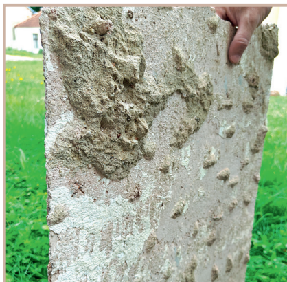
↑ Obr. 31: Chvalešovice, dům čp. 19, detail porušení omítky vlivem příliš hladkého podkladu, nedost. přilnavost. Foto: David Javorský, 2024
